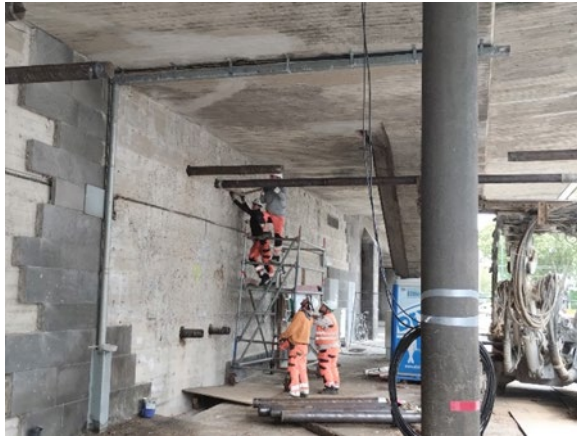
Rampe: Zugbandertüchtung ➤ Weitere Schäden festgestellt
