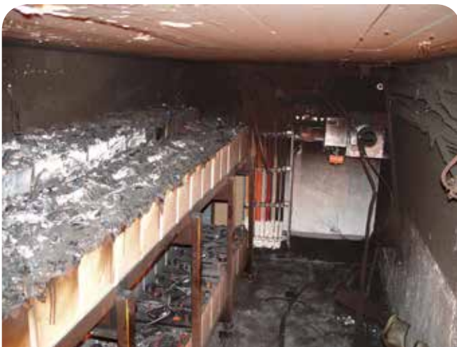
Dieser Batteriepuffer brannte im Januar 2013 in einem Keller eine großen Bankfilliale.
