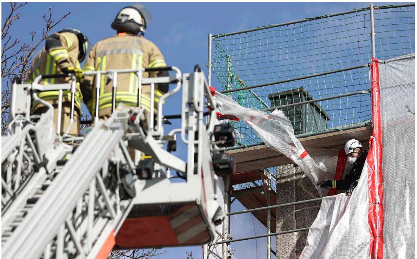
Einsatzkräfte der Feuerwehr entfernen während eines Sturms lose Teile einer Plane an einem Baugerüst.
