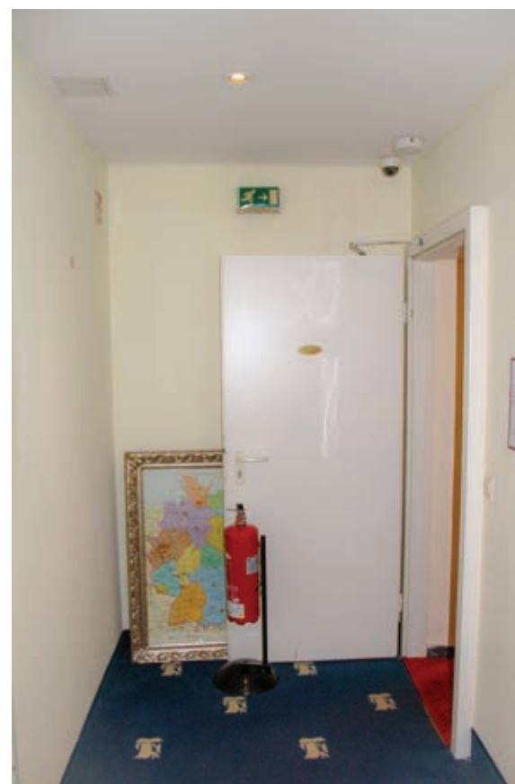
Oftmals gesehen: Feuerlöscher hält Brandschutztür offen
