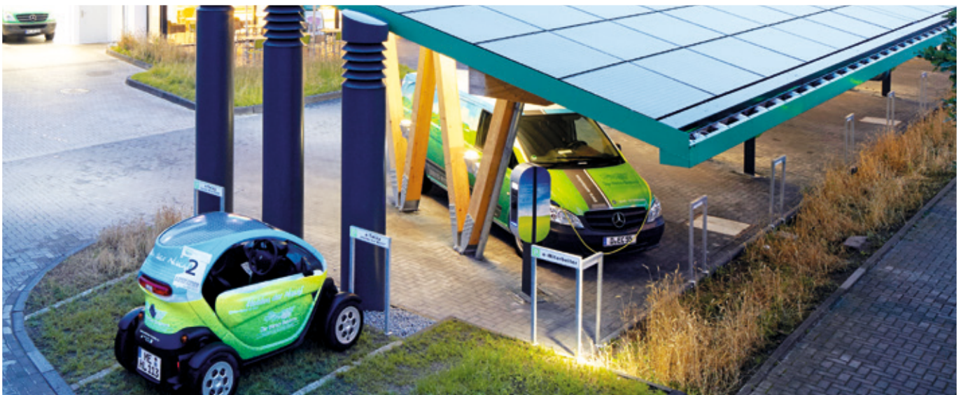
Solar-Carport mit Ladestationen bei Ihr Bäcker Schüren in Hilden
