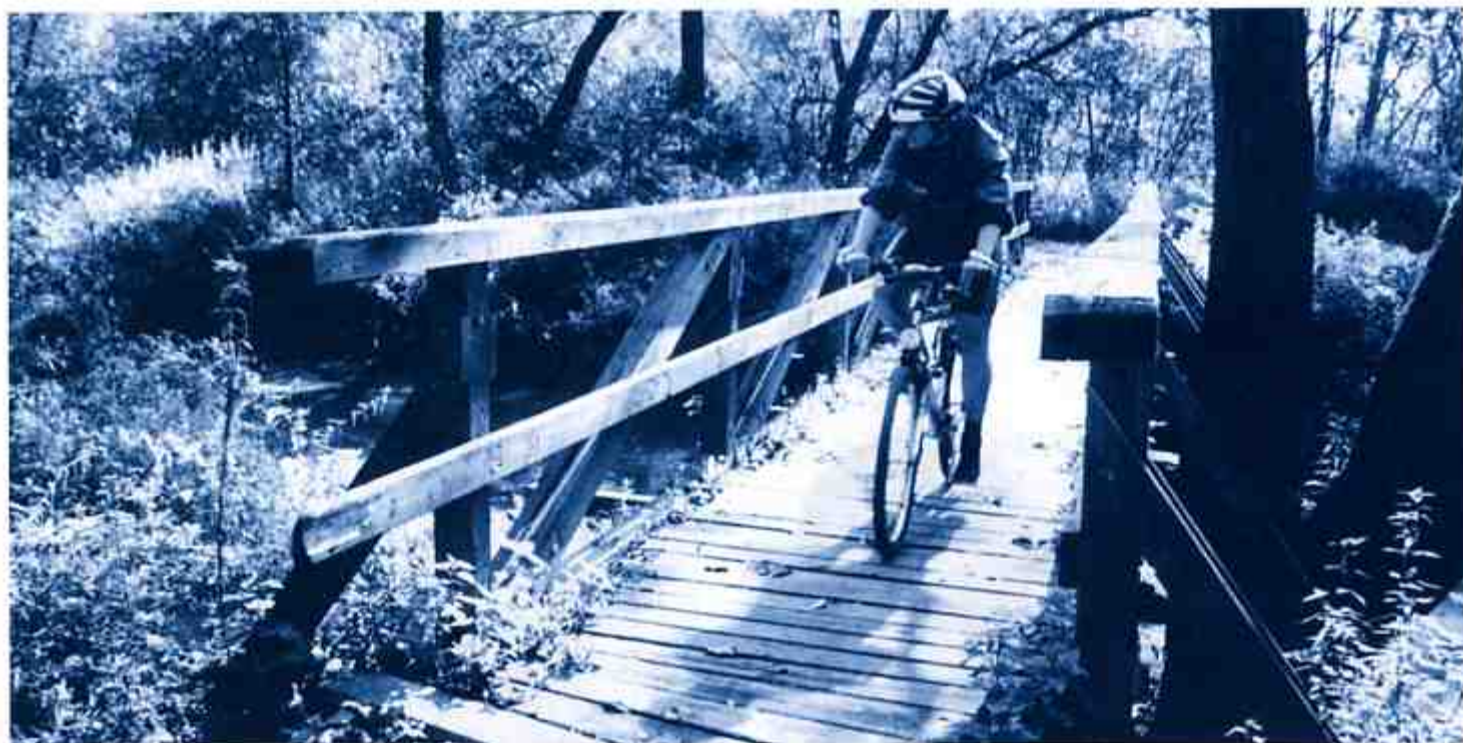
Die hölzerne Fußgängerbrücke wirkt schon recht morsch. Im Herbst 2000 wird eine neue Brücke gebaut.
